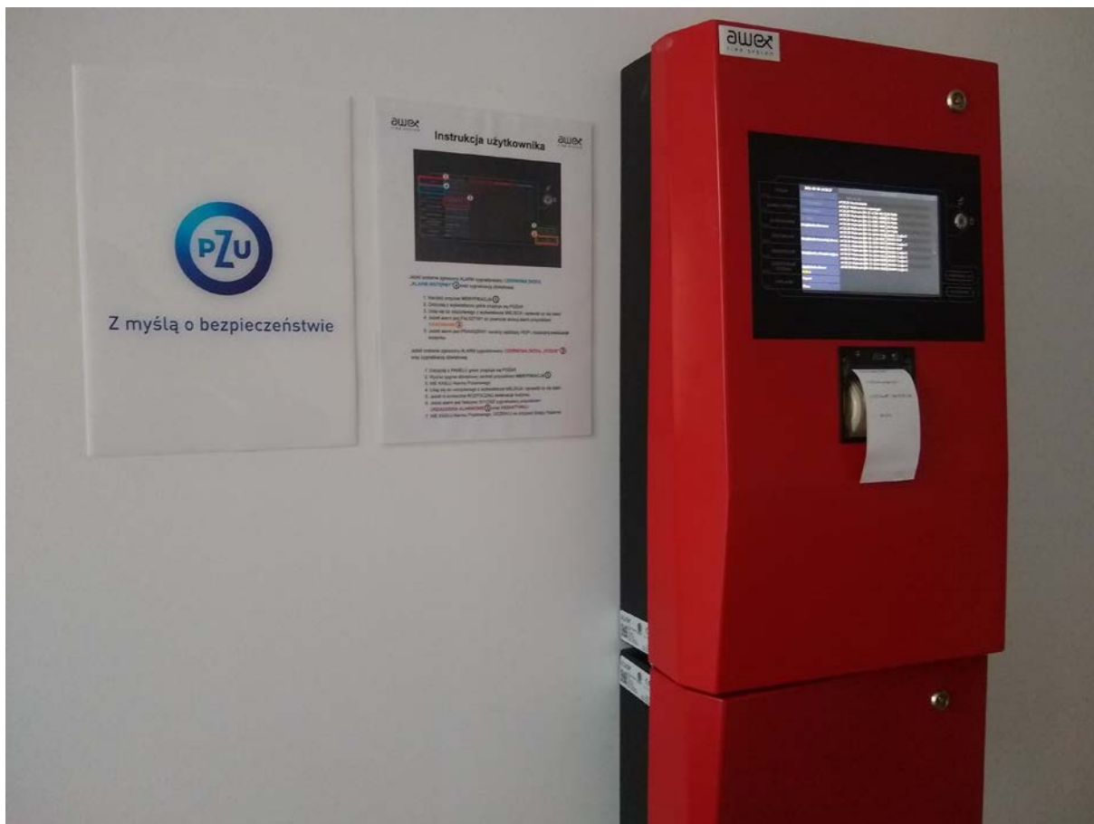
Centralka sygnalizacji pożaru w pomieszczeniu ochrony obiektu
