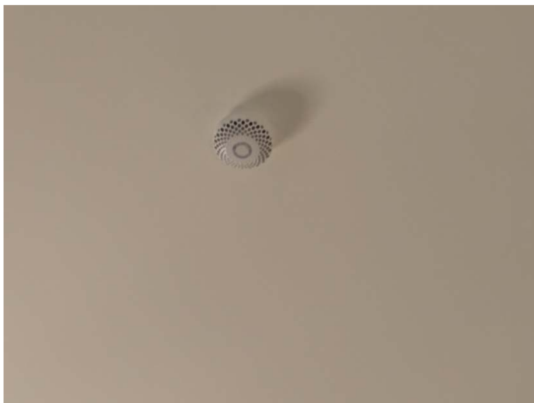
Elementy instalacji alarmowej SSP w budynku
