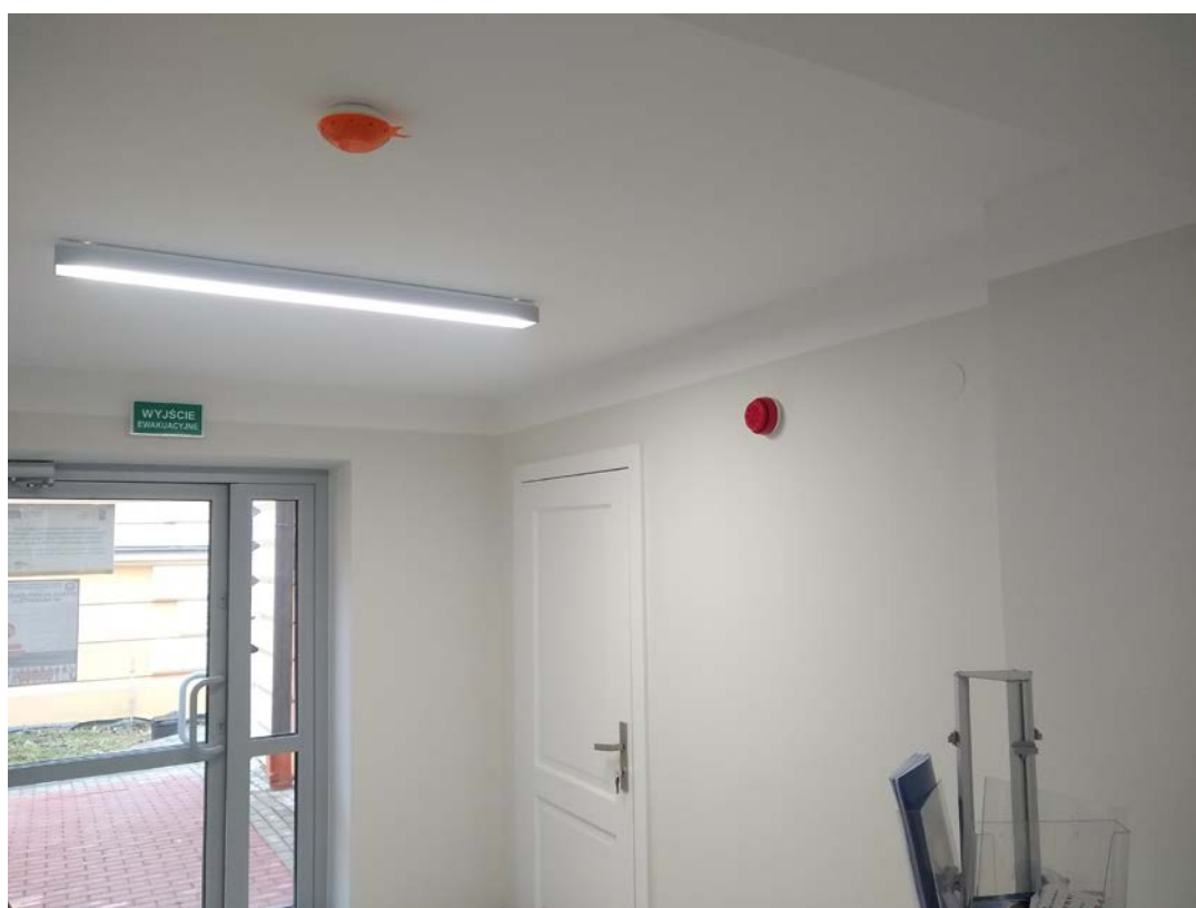
Elementy instalacji alarmowej SSP w pobliżu wyjścia ewakuacyjnego
