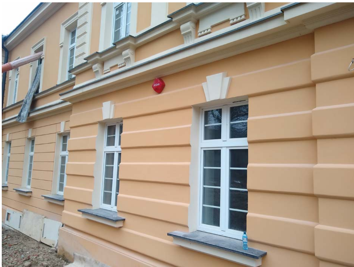
Sygnalizator alarmowy SSP na zewnątrz budynku
